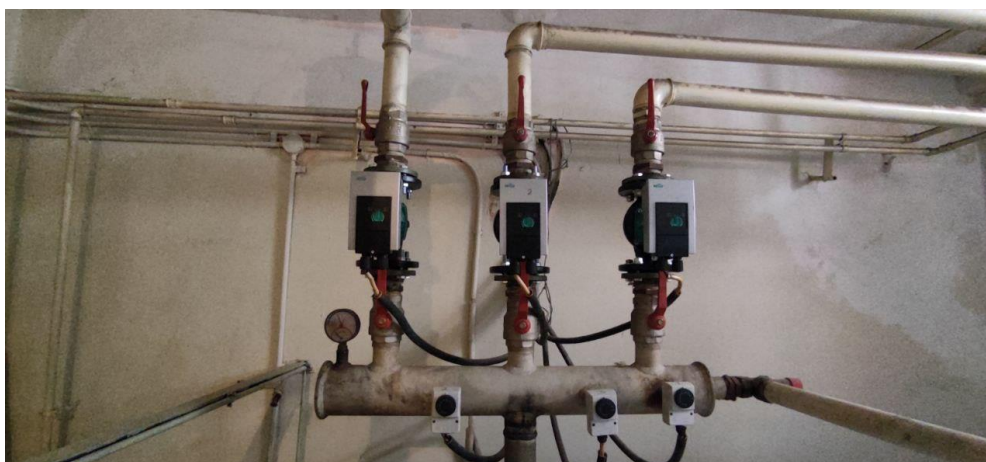
Εικόνα 33: Διάταξη κυκλοφορητών δικτύου διανομής λεβητοστασίου.
