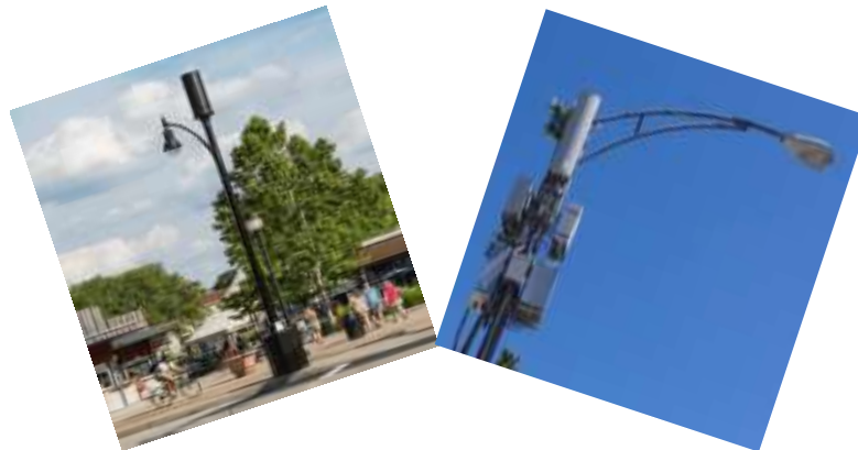
Εικόνα 38: Κουτιά Μικρών Κυψελών Τοποθετημένα στο Κάτω Μέρος ή στην Κορυφή των Στύλων Φωτισμού.
