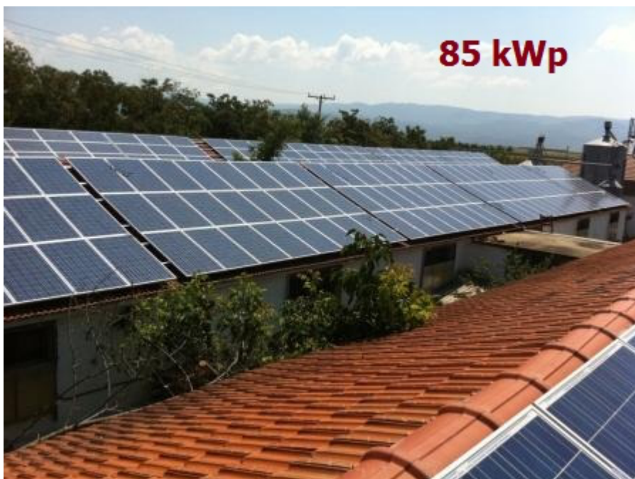
Εικόνα 9:Φωτοβολταϊκό Πάρκο 85 kWp
