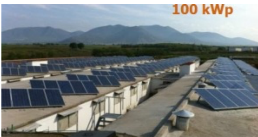
Εικόνα 10:Φωτοβολταϊκό Πάρκο 100 kWp
