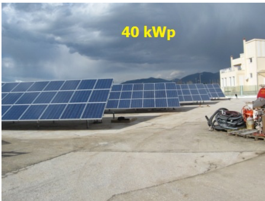
Εικόνα 8: Φωτοβολταϊκό Πάρκο 40 kWp
