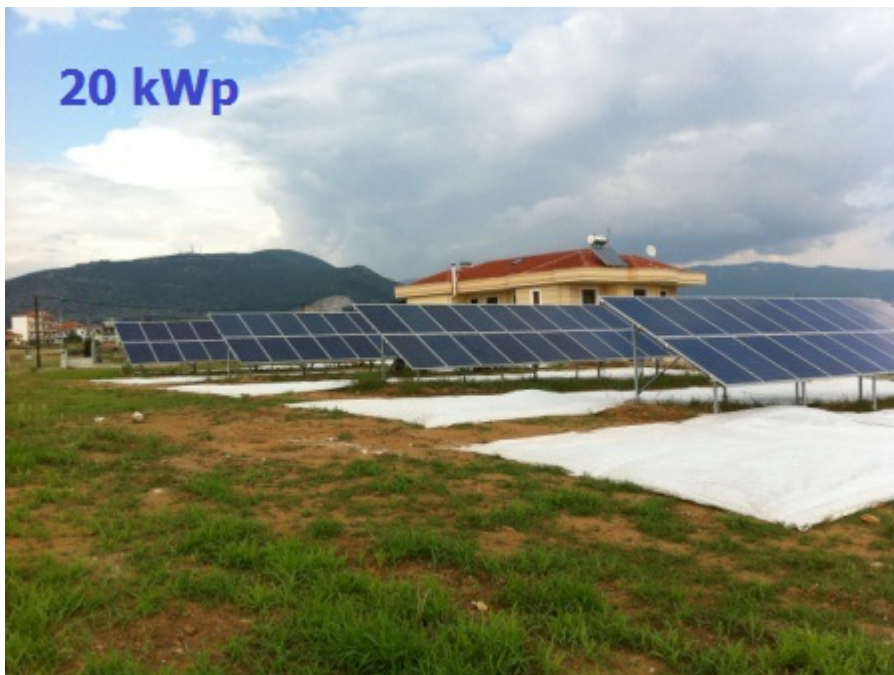
Εικόνα 7: Φωτοβολταϊκό Πάρκο 20 kWp
