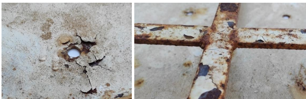
Εικόνα 40: Αποκόλληση και ρηγματώσεις μπεζ χρωματικού στρώματος στο πίσω μέρος του θυρεού περιμετρικά μίας οπής.
