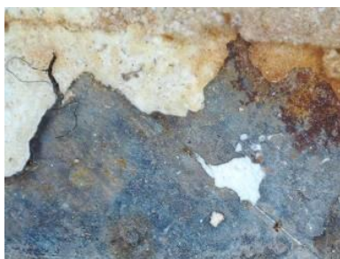
Εικόνα 32: Απώλεια χρωματικών στρωμάτων με αποτέλεσμα την έκθεση του υποκείμενου μετάλλου (σίδηρος).
