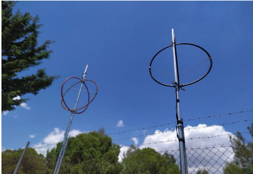
Εικόνα 77. Εγκατάσταση κεραιών για την υποστήριξη δεκτών λήψης προσεισμικών σημάτων στην θέση Άσπρα Χώματα, Πετρούπολη Αττικής.
