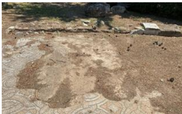
Εικόνα 65. Συσσώρευση ιζημάτων χώματος, φύλλων και φερτών υλικών πάνω στο δάπεδο.
