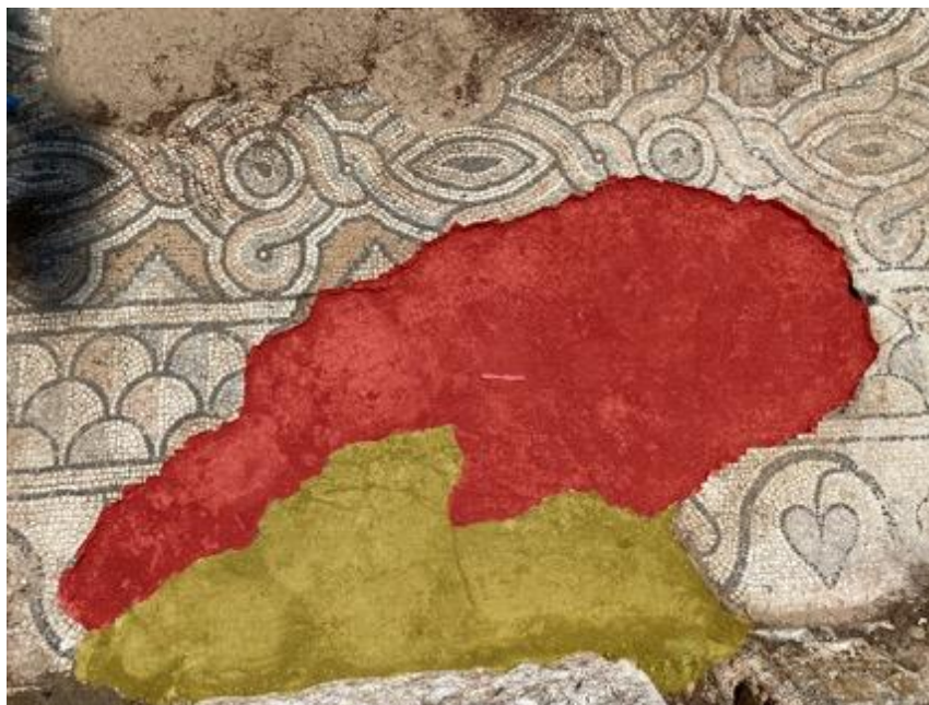
Εικόνα 84. Η διαφοροποίηση της έκτασης της απώλειας, που οφείλεται στην παραμέληση και στη διέλευση πεζών και στην αποσάθρωση των κονιαμάτων στερέωσης. Με κίτρινο η απώλεια το 2013. Με κόκκινο η επέκταση της απώλειας το 2021.
