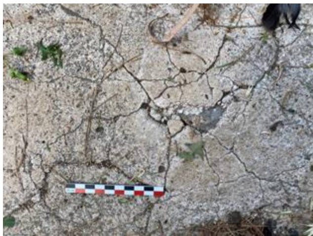
Εικόνα 80. Ρωγμές, που επεκτείνονται στην επιφάνεια του κονιάματος συμπλήρωσης.
