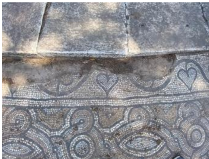
Εικόνα 75. Η καθίζηση, όπως εκδηλώνεται στο ψηφιδωτό στο Ζάππειο.
