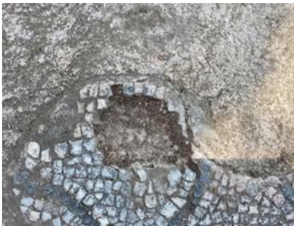
Εικόνα 73. Απώλεια ψηφίδων και εμφάνιση του κονιάματος του υποστρώματος.
