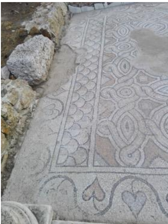
Εικόνα 82. Το σημείο απώλειας στο βορειοδυτικό άκρο του ψηφιδωτού με περιμετρική στερέωση, που υλοποιήθηκε το 2013. ©(ΕΦΑ 2017)
