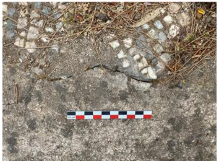
Εικόνα 78. Ρωγμές, που εκδηλώνονται επιφανειακά αλλά οφείλονται σε φθορές εις βάθος.
