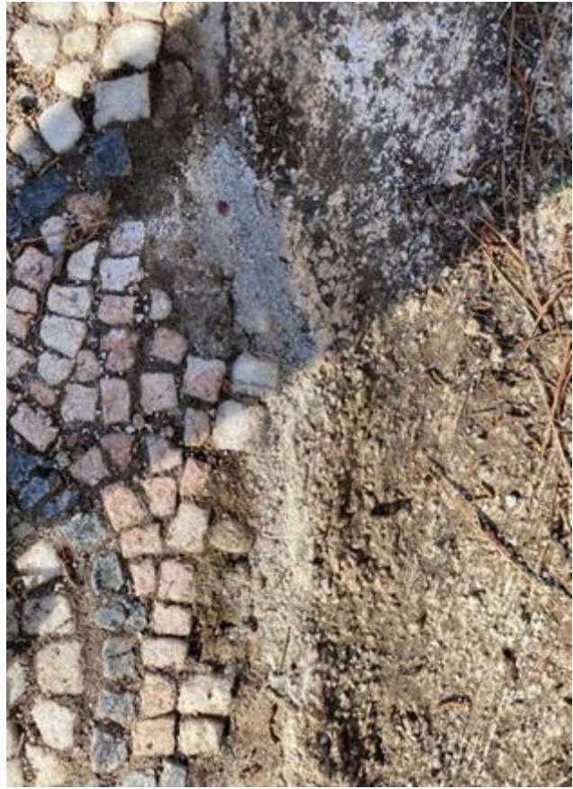
Εικόνα 152. Ρωγμή μεταξύ ψηφιδωτού και κονιάματος μετά την πλήρωση με κονίαμα.
