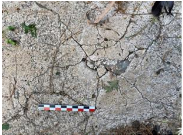
Εικόνα 90. Το ασβεστοκονίαμα συμπλήρωσης με ρωγμές και απώλειες και εμφανή το γεωύφασμα.
