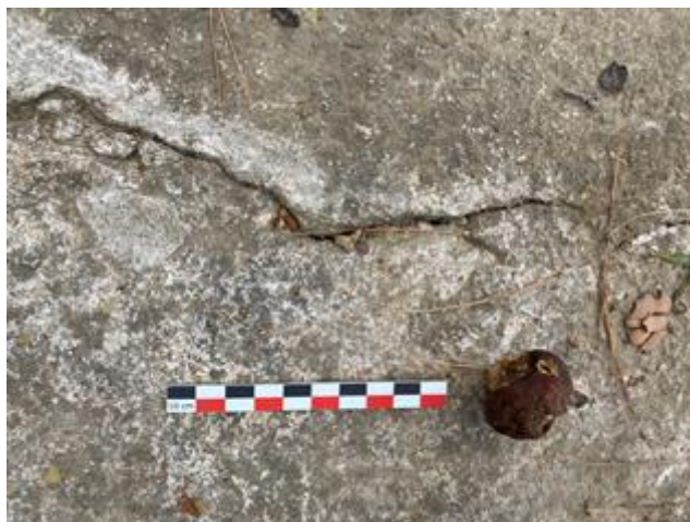
Εικόνα 81. Μεγάλη ρωγή μεμονωμένη στο κονίαμα συμπλήρωσης.
