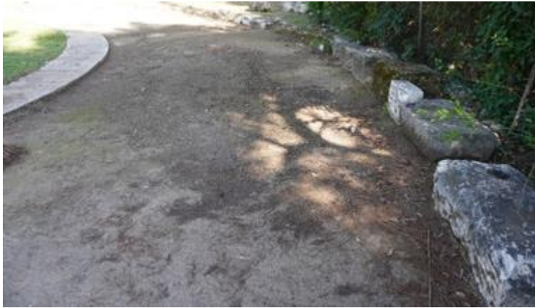
Εικόνα 46. Η κατάσταση διατήρησης του ψηφιδωτού με ιζήματα χώματος και φερτών υλικών. Οκτώβριος 2021.
