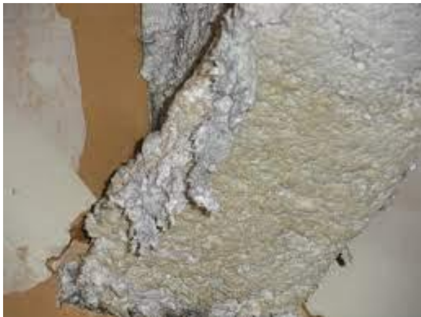
Εικόνα 2.1: Αμίαντος που χρησιμοποιείται ως μονωτικό υλικό (Πηγή: Dansikt, 2016, Asbestos from https://commons.wikimedia.org/ )
