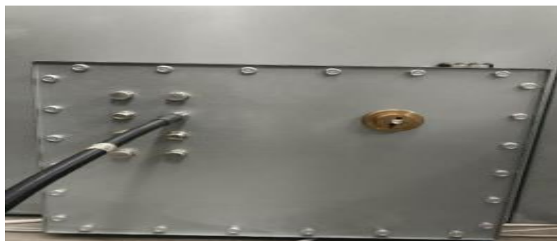
Εικόνα 3.18 -Πάνελ εισόδου καλωδιώσεων εντός του ανηχοϊκού θαλάμου
