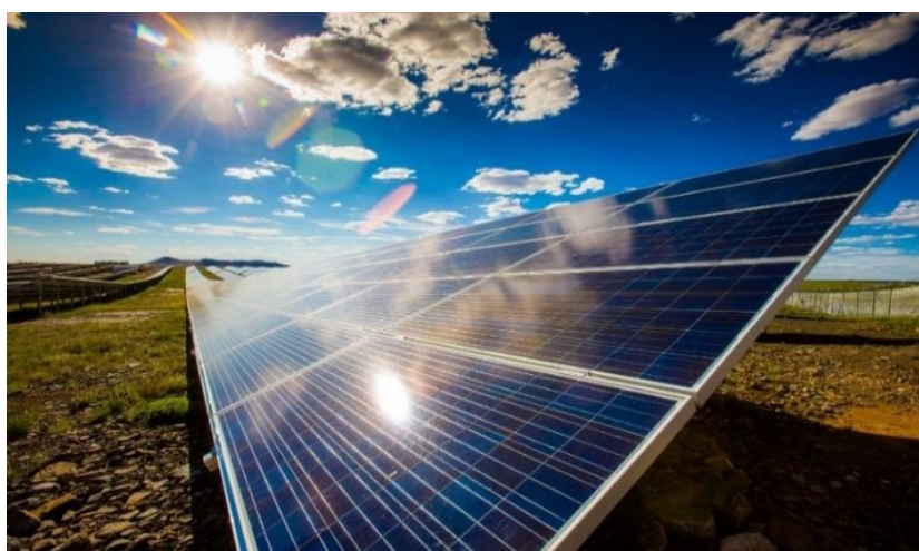
Εικόνα 43 Φωτοβολταϊκά συστήματα (πηγή: https://commonality.gr/tag/iliaki-energia )
