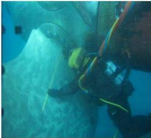
Εικόνα 63. Συντήρηση από δύτη. Πηγή: A Study on the Developing concepts of Underwater Construction.
