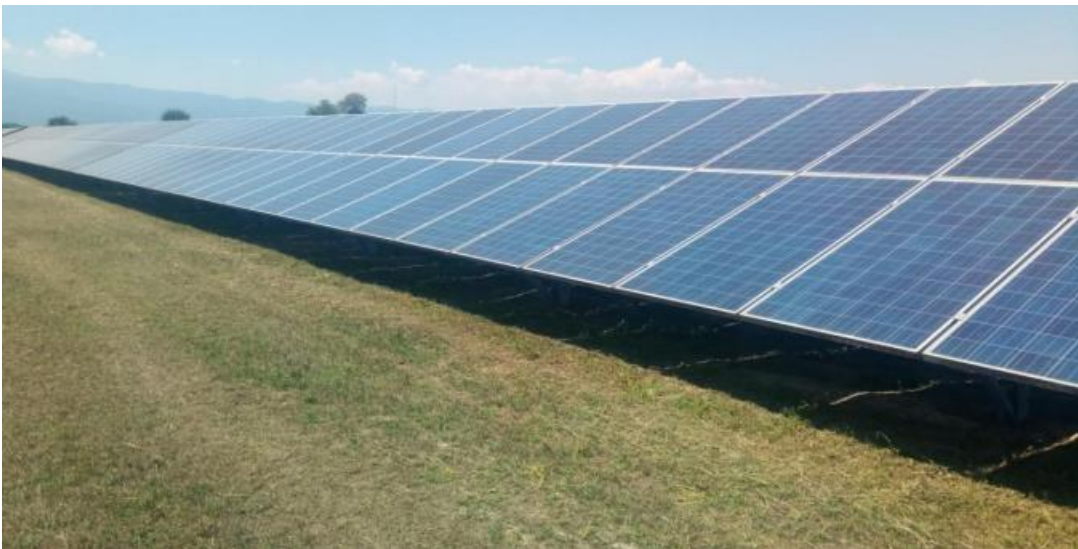
Εικόνα 32. Φωτοβολταϊκά πάνελ. Πηγή: «Η Επίδραση της Μετεωρολογίας στα Φωτοβολταϊκά Συστήματα στην Ελλάδα», Αθηνά Μαύρου.
