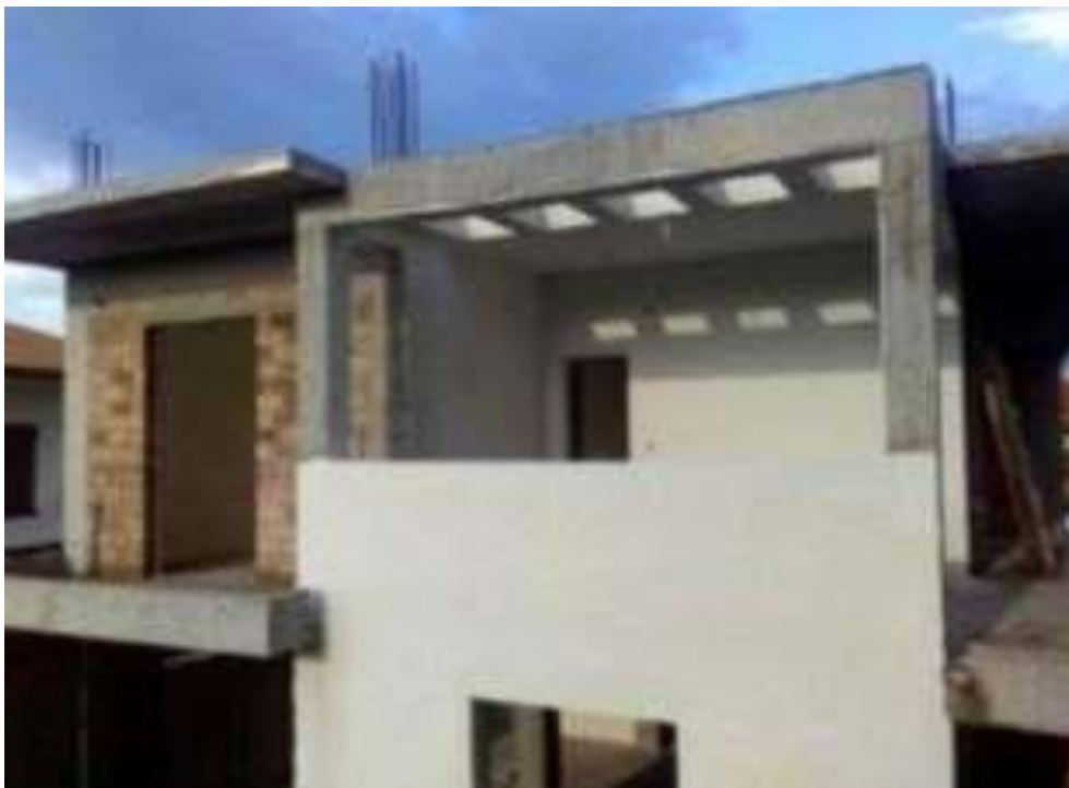
Εικόνα 8.6) Κτίριο στις Αλυκές Αχαΐας σχεδιασμένο με βάση τους κανονισμούς για κτίρια κατηγορίας A+
