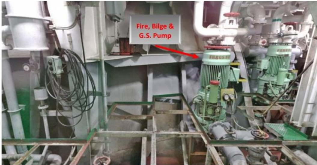
Εικόνα 26: Τρισδιάστατη απεικόνιση της αντλίας Fire, Bilge & G.S Pump στο E/R Floor Deck
