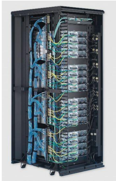
Εικόνα 6: Εσωτερικό rack διανομής (NetRack)
