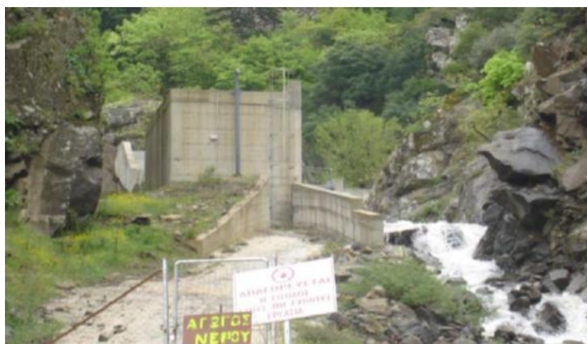
Σχήμα 4.45 Δεξαμενή φόρτισης μικρού ΥΗΕ Κρύας Βρύσης, Δήμος Υπάτης, Φθιώτιδας, Ισχύς 0,735 MW, 2006. [I12]
