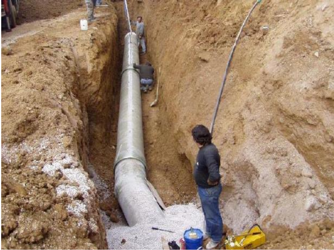
Σχήμα 4.56 Υπόγειος αγωγός μικρού υδροηλεκτρικού Κρύας Βρύσης, Φθιώτιδα με ισχύ 0,735 MW, 2006. [I13]
