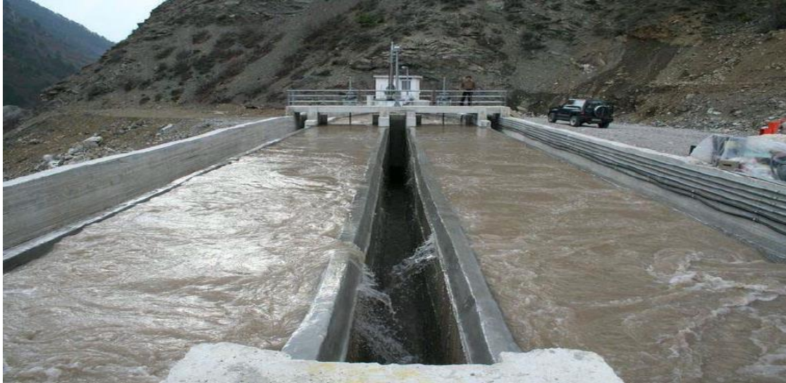
Σχήμα 4.36 Εξαμωπής μικρού υδροηλεκτρικού στο Θερμόρεμα, Σπερχειάδα Φθιώτιδας, Ισχύς 1,95 MW, 2003 [112]
