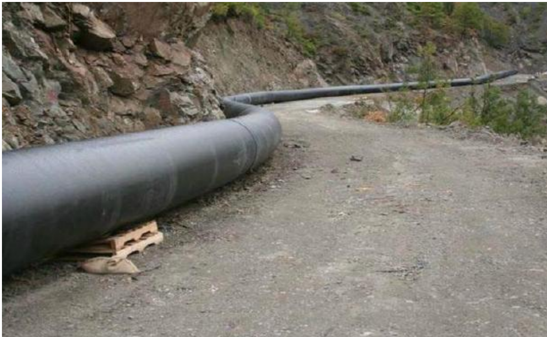
Σχήμα 4.57 Υπέργειος αγωγός μικρού υδροηλεκτρικού Θερμόρεμα, Σπερχειάδα Φθιώτιδας με ισχύ 1,95 MW, 2003. [I13]
