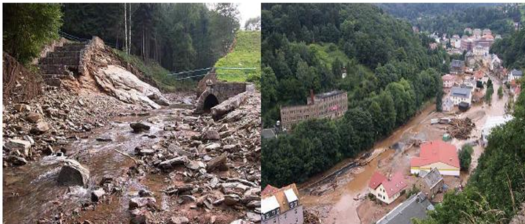
Σχήμα 4.16 Αστοχία μικρού φράγματος και πλημμύρα κατάντη. [Ξ1, Photo 5.3]
