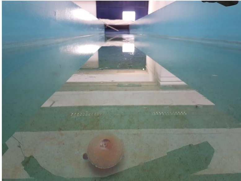
Εικόνα 10. Κατάσταση ανοδίου και παρουσία βιορύπανσης στην επιφάνεια και στον πυθμένα της δεξαμενής.
