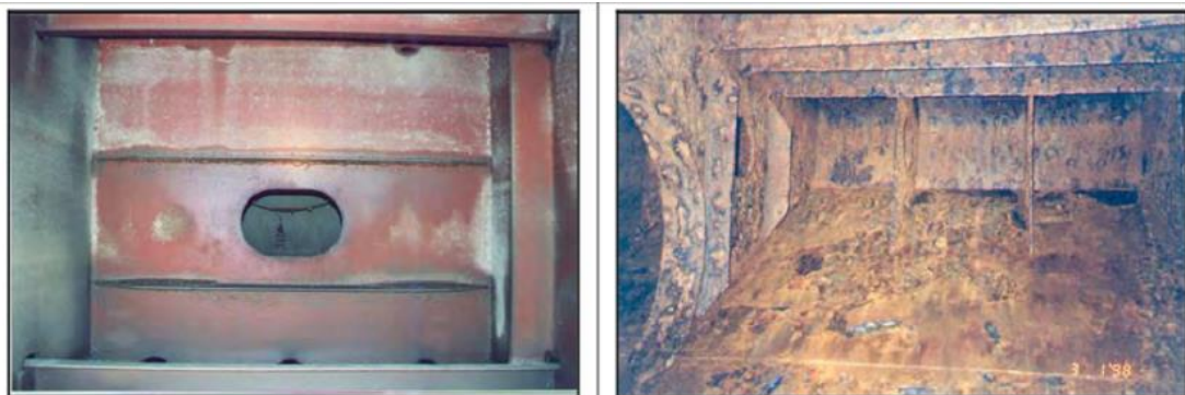
Εικόνα 1. Αποτέλεσμα διάβρωσης δεξαμενής έρματος [11].
