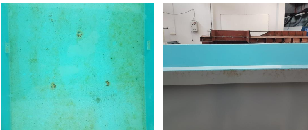
Εικόνα 8. Αριστερά: Σημάδια σκουριάς από τη διάβρωση που προκαλείται με την τοποθέτηση βάσης στήριξης για τη διεξαγωγή πειραμάτων. Δεξιά: μικρής έκτασης επιφανειακή σκουριά στην κουπαστή της δεξαμενής από ατμοσφαιρική διάβρωση.
