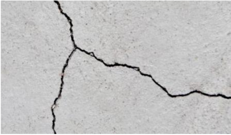
Σχήμα 4.14 Τυπική ρωγμή σε πλάκα
