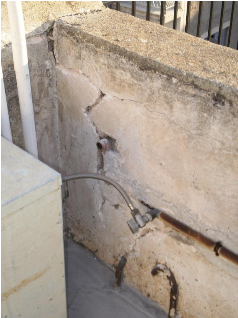
Σχήμα 4.15 Κλασικές ρωγμές σε παλαιά κτίρια
