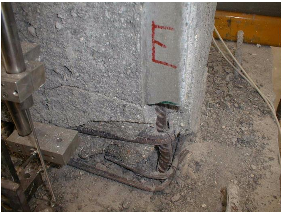
Σχήμα 1.9 Αστοχία σκυροδέματος – Αποκάλυψη οπλισμού
