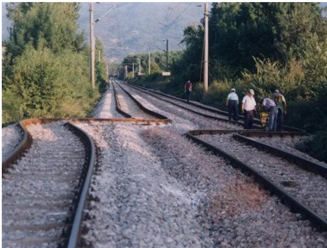
Εικόνα 6: Παραμόρφωση σιδηροδρομικών γραμμών που βρίσκονται πάνω στο διερχόμενο ρήγμα (Πηγή: Variations in Creep Along One of Earth's Most Active Faults - Eos )
