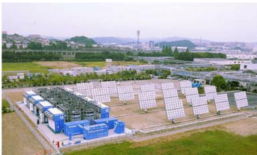
Εικόνα 3.10(2)- Εγκατάσταση μπαταρίας ροής πολυσουλφιδίου Regenysis (πηγή :
