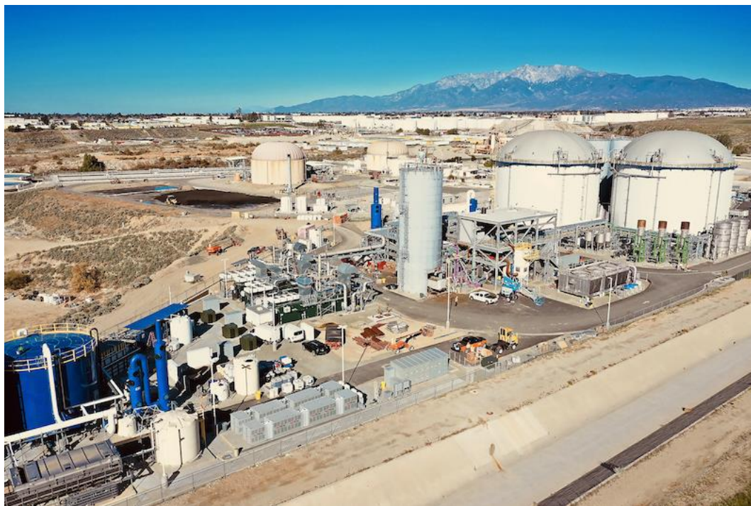
Εικόνα 3.10(4)- Η Redflow προμηθεύει 2MWh μπαταριών ροής ψευδαργύρου-βρωμίου σε μονάδα βιοενέργειας στην Καλιφόρνια (πηγή : https://www.google.com/url?sa=i&url=https%3A%2F%2Fwww.energy-
