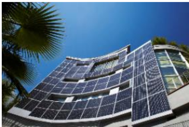
Εικ.42-Φωτοβολταϊκά πάνελ τοποθετημένα στις όψεις κτηρίων
