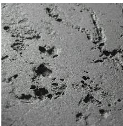
Εικ. 2.13: Διάβρωση με βελονισμούς σε χάλυβα [18]
