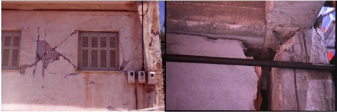
Εικόνα 7.1: Αστοχία ασθενών υποστυλωμάτων εξαιτίας ισχυρών τοιχοπληρώσεων
