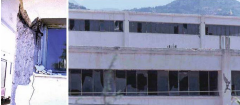
Εικόνα 7.2: Περιπτώσεις αστοχίας κοντών υποστυλωμάτων
