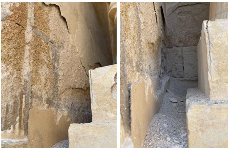
Εικόνα 37: Απώλεια και αποκόλληση-ανασήκωση του κονιάματος επίχρισης από το υπόστρωμα του αριστερού πλάγιου τοίχου και ημικίονα.
