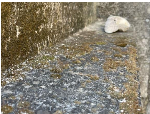
Εικόνα 41: Ανάπτυξη βρύων κατά μήκος της βάσης, όπου εδράζονται οι Ιωνικοί ημικίονες (πλάγια δεξιά όψη).
