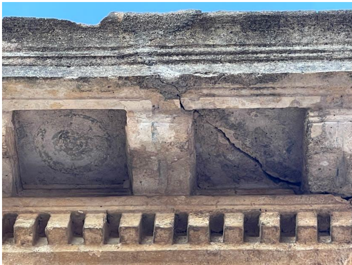
Εικόνα 32: Θραύση του οριζόντιου γείσου, όπως φαίνεται από την πλάγια αριστερή όψη.
