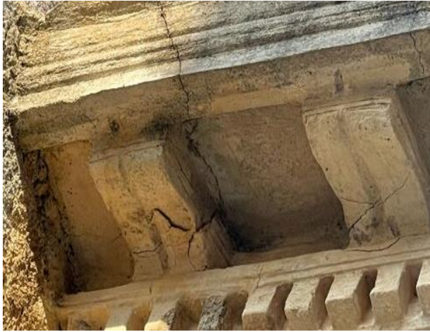
Εικόνα 31: Λεπτομέρεια της πλάγιας από τα αριστερά όψης του γείσου όπου έχουν προκληθεί ρωγμές.
