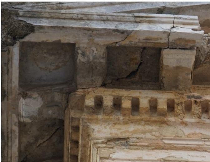
Εικόνα 24: Θραύση του οριζώντιου γείσου.
