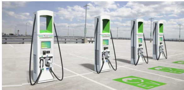
Εικόνα 30 : Σταθμός Φόρτισης Η/Ο
