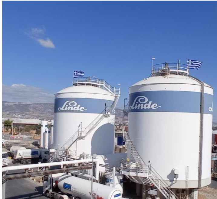
Εικόνα 7. Εγκαταστάσεις της Linde στην Μάνδρα Αττικής 39 .
