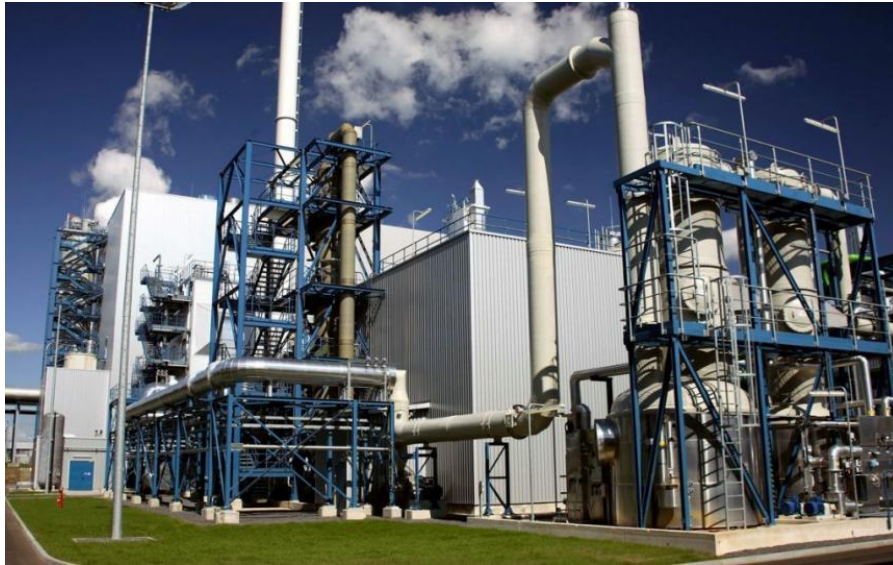
Εικόνα 6.1. Εγκαταστάσεις της Λάρισας Θερμοηλεκτρικής Μ.Α.Ε 30 .
