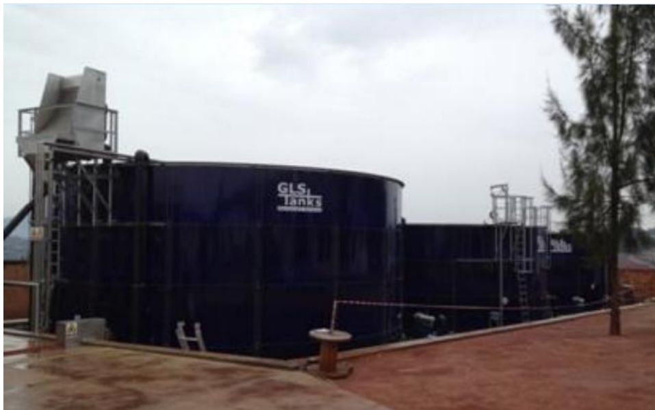
ΕΙΚΟΝΑ 11. Μονάδα Επεξεργασίας Αποβλήτων στο Kigali – Rwanda ΠΗΓΗ www.ecc.com
