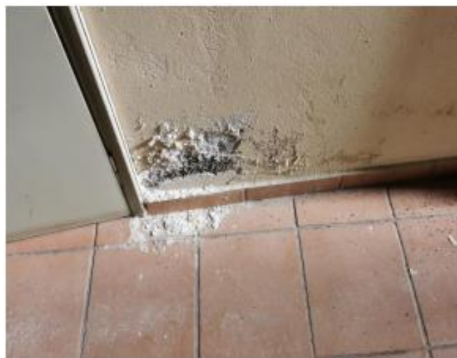
Σχήμα 2.40 Εμφανής υγρασία βόρειας τοιχοποιίας προσθήκης
