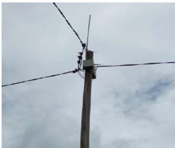
Σχήμα 25 : Σταθμός βάσης LoRa που εγκαταστάθηκε στον πόλο.
