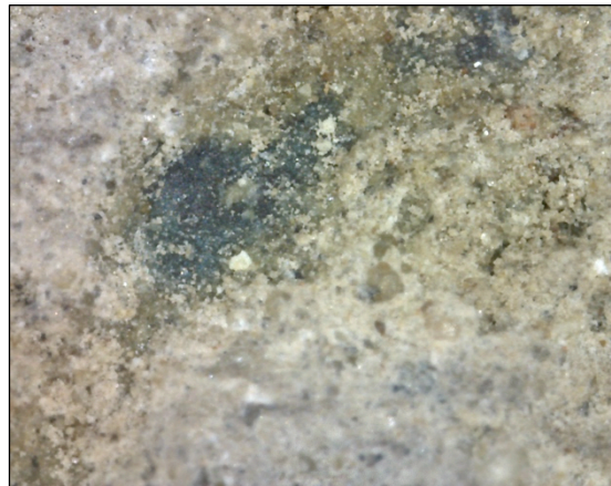
Φωτ. 6.41 Προϊόντα διάβρωσης χαλκού (σκούρο και ανοιχτό πράσινο), (x215), (Τρουλλινού Α.©)
