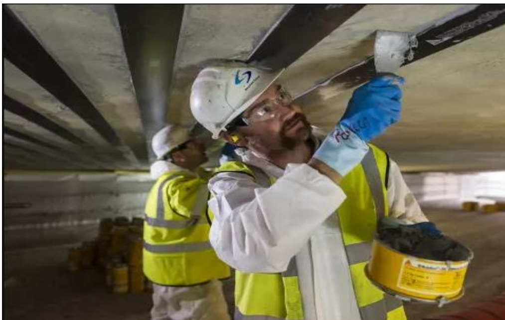
Σχήμα 4.25 Ενίσχυση πλάκας με επικολητά χαλύβδινα ελάσματα ( Επικολλούμενος εξωτερικός οπλισμός - ελάσματα | Sika Hellas )
