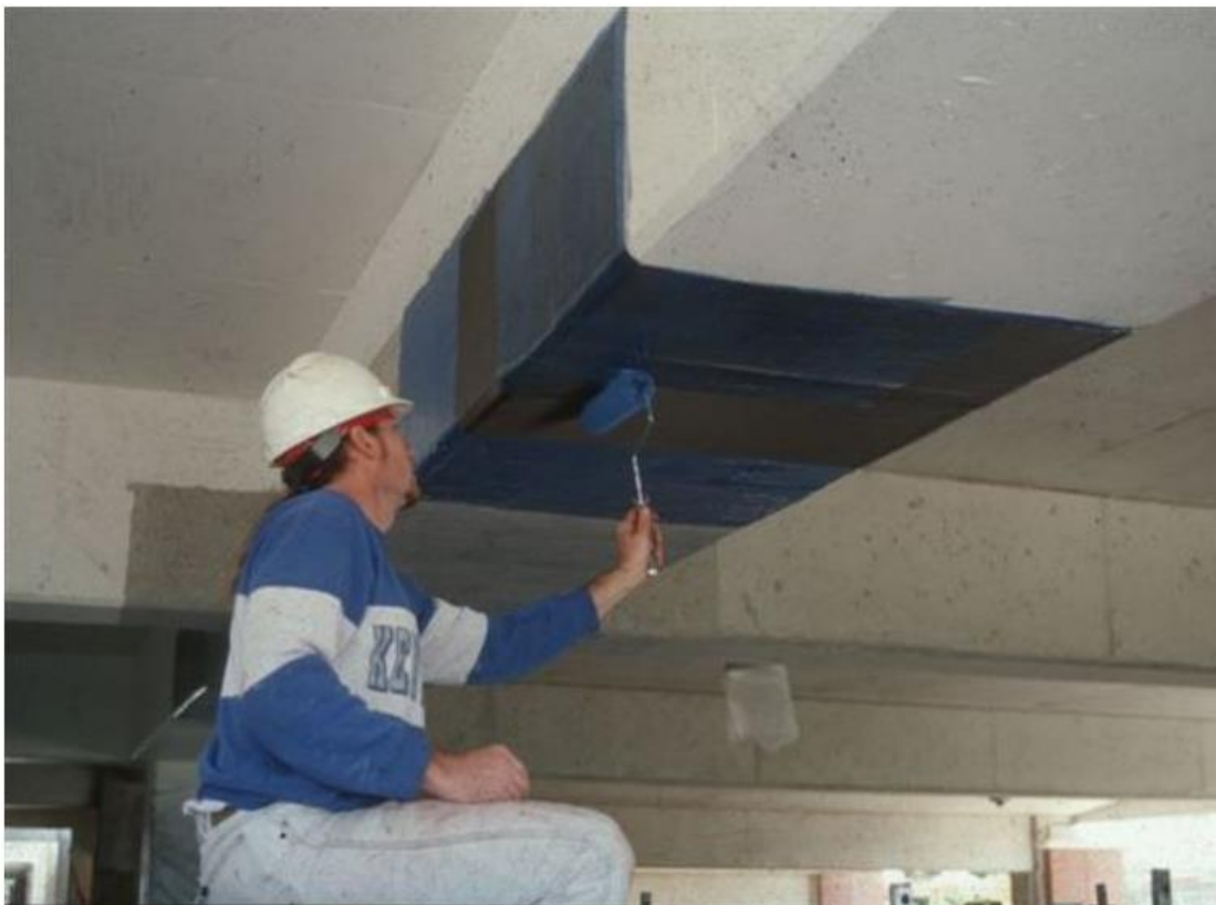
Σχήμα 4.16 Ενίσχυση δοκού με υφάσματα ιοπ κάθετα στον άξονα του μέλους με σκοπό την αύξηση της διατμητικής αντοχής του ( https://monosimacon.blogspot.com )
