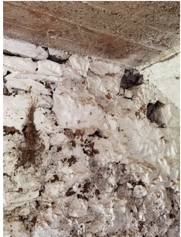
Ανάγκη για σωστό και σχολαστικό αρμολόγημα με ταυτόχρονη απομάκρυνση βλάστησης
