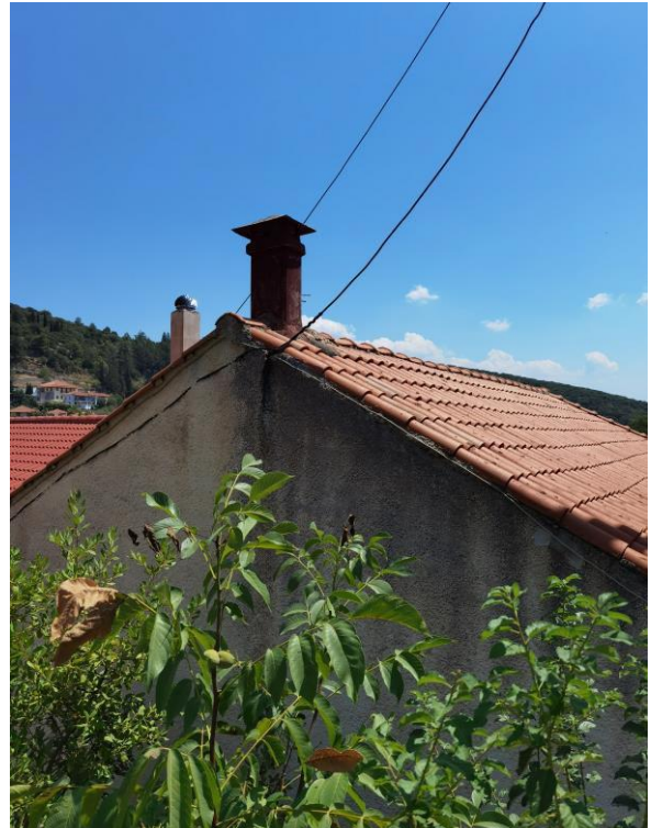
Συγκέντρωση υγρασίας στη διεπιφάνεια μεταξύ επιχρίσματος και τοιχοποιίας με αποτέλεσμα την εμφάνιση μούχλας
