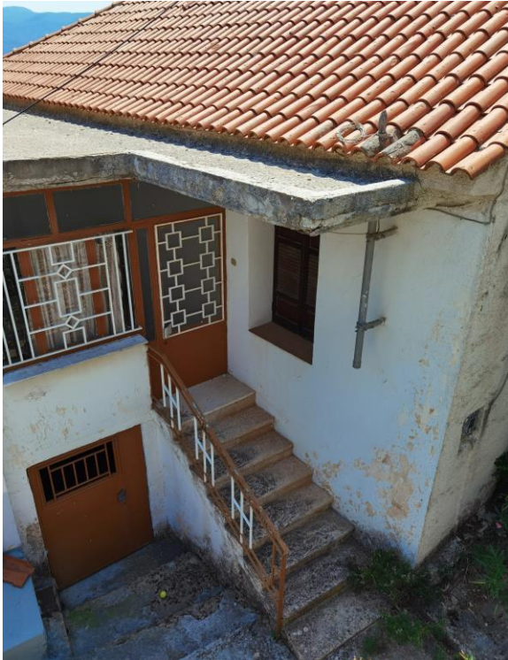
Χαρακτηριστικό παράδειγμα αποφλοιώσεων και επανθισμάτων λόγω υγρασίας
