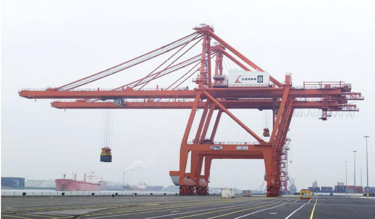
Εικόνα 16 – Γερανογέφυρα QC / STS
