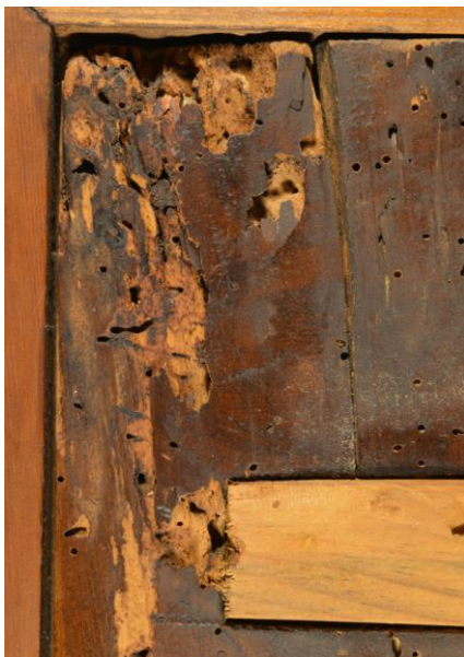
Εικόνα 1-17: Απώλειες και οπές ξύλινου φορέα
