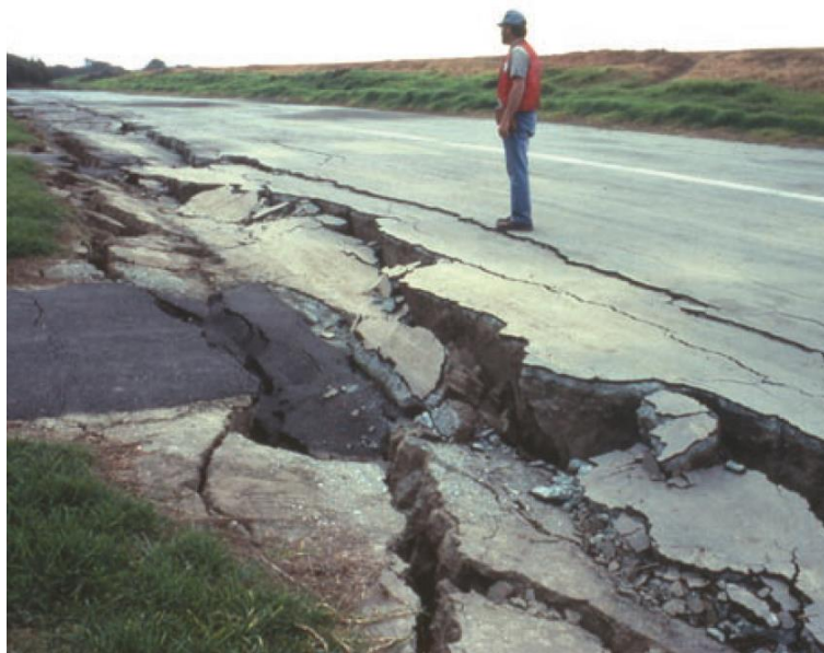
Εικόνα 2.10 – Πλευρική εξάπλωση λόγω σεισμού στη Loma Prieta, Καλιφόρνια, Αμερική 1989 (Highland L. 2008)
