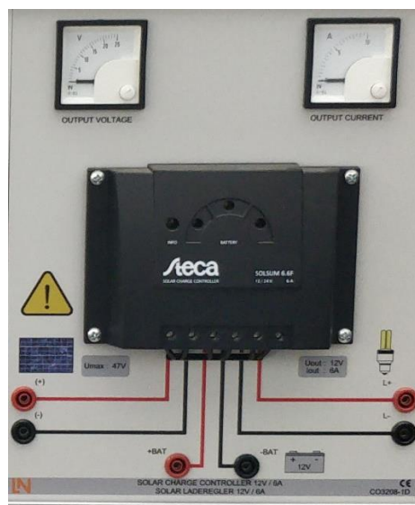
Σχήμα 1.7: Φωτογραφία του Charge Controller της εγκατάστασης
