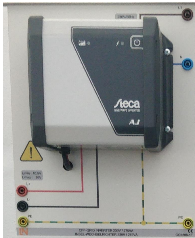
Σχήμα 1.5: Φωτογραφία του inverter της εγκατάστασης
