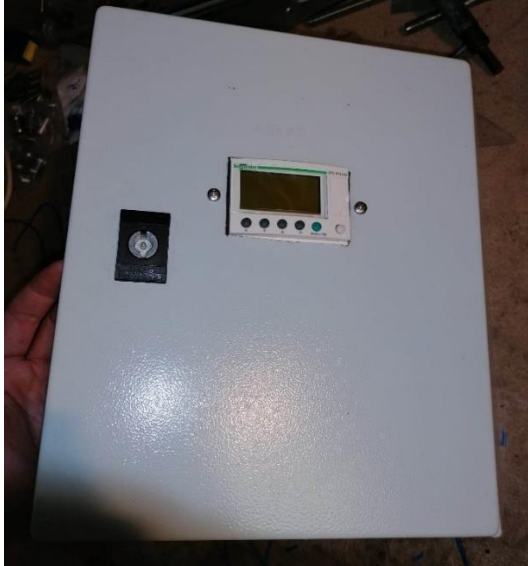
Εικόνα 30: Εφαρμογή μικροελεγκτή στην πόρτα του πίνακα για εξοικονόμηση χώρου και για την χρήση των μπουτόν και της οθόνης.
