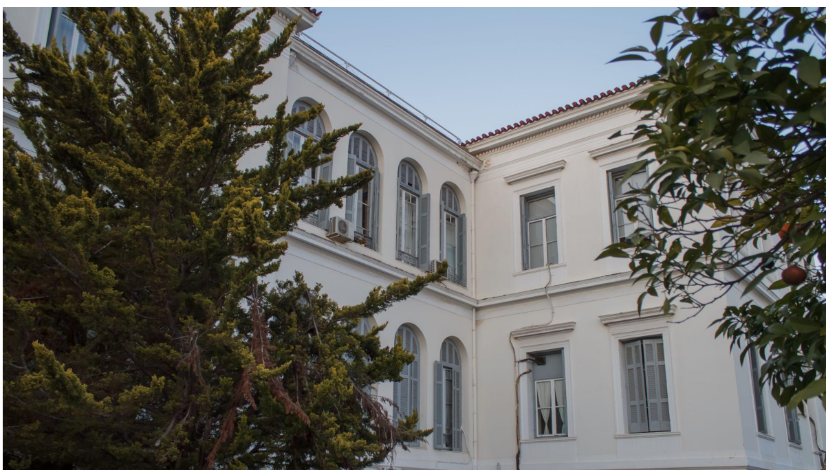
Δυτικομεσημβρινό κτίριο και οι προσθήκες στις “συνδέσεις” με το κεντρικό κτίριο,, Πέταρ Πετκόβ, 17 Φεβρουαρίου 2023, Αθήνα
