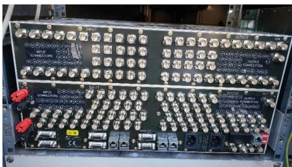
Εικόνα 14: Πίσω πλευρά σύνδεσης των καλωδίων ενός router
