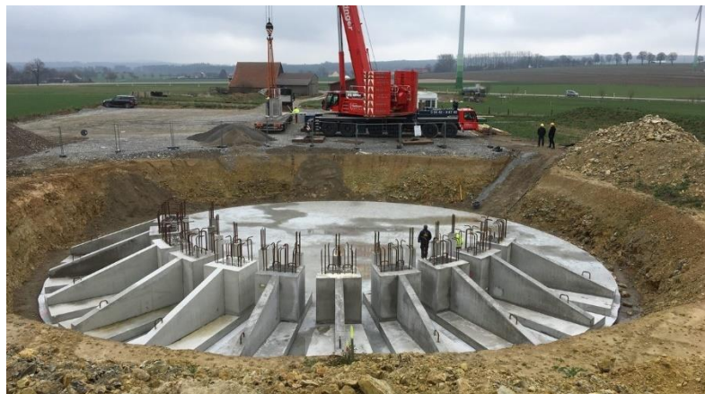
Εικόνα 5: Βάση χερσαίας ανεμογεννήτριας. Πηγή: https://www.theconstructionindex.co.uk/news/view/start-up-launches-new-foundations-for-wind-turbines
