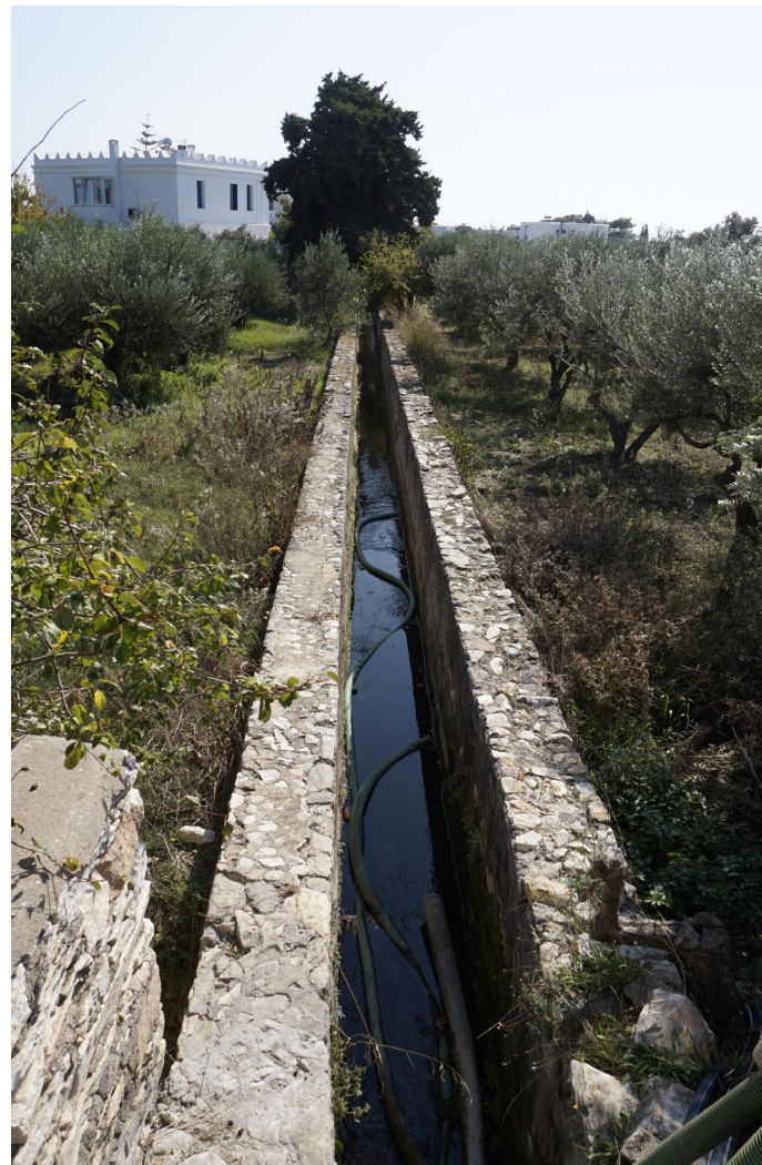
Εικ.9 Αγωγός νερού
