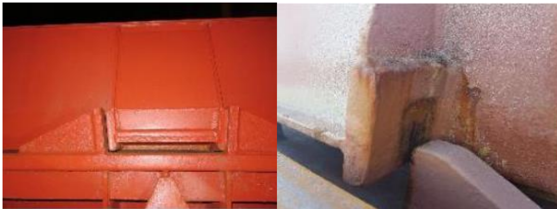
(Εικόνα 3.15: Μηχανισμός τοποθέτησης σε καλή κατάσταση (αριστερά) & μηχανισμός τοποθέτησης με σημάδια φθοράς (δεξιά) - https://imcs-training.eu/wp-content/uploads/sites/2/2019/10/Minimanual-Locators-clearance-folding-hatch-covers-v0.1.pdf )
