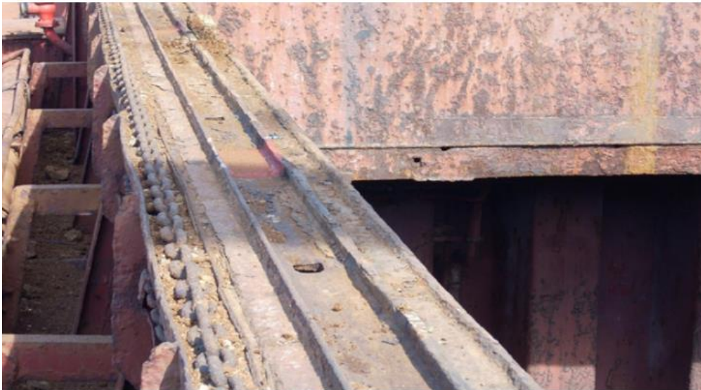
(Εικόνα 3.12: Poorly maintained drain channel / Κακοσυντηρημένο κανάλι αποστράγγισης – www.standard-club.com )
