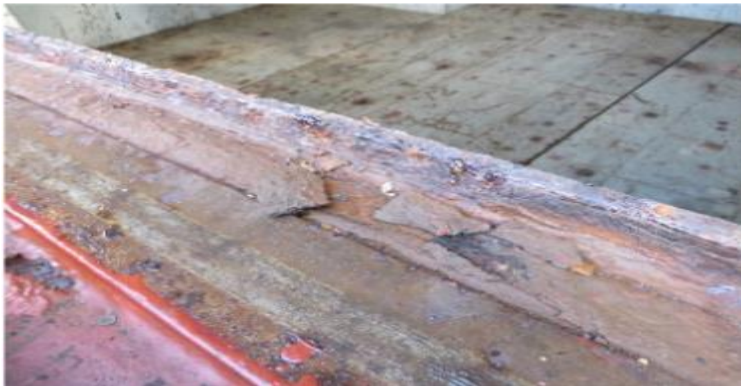
(Εικόνα 3.10: Corroded / Wasted Compression Bar / Σκουρισμένη και φθαρμένη μπάρα συμπίεσης - https://www.gard.no/web/articles?documentId=34116490 )
