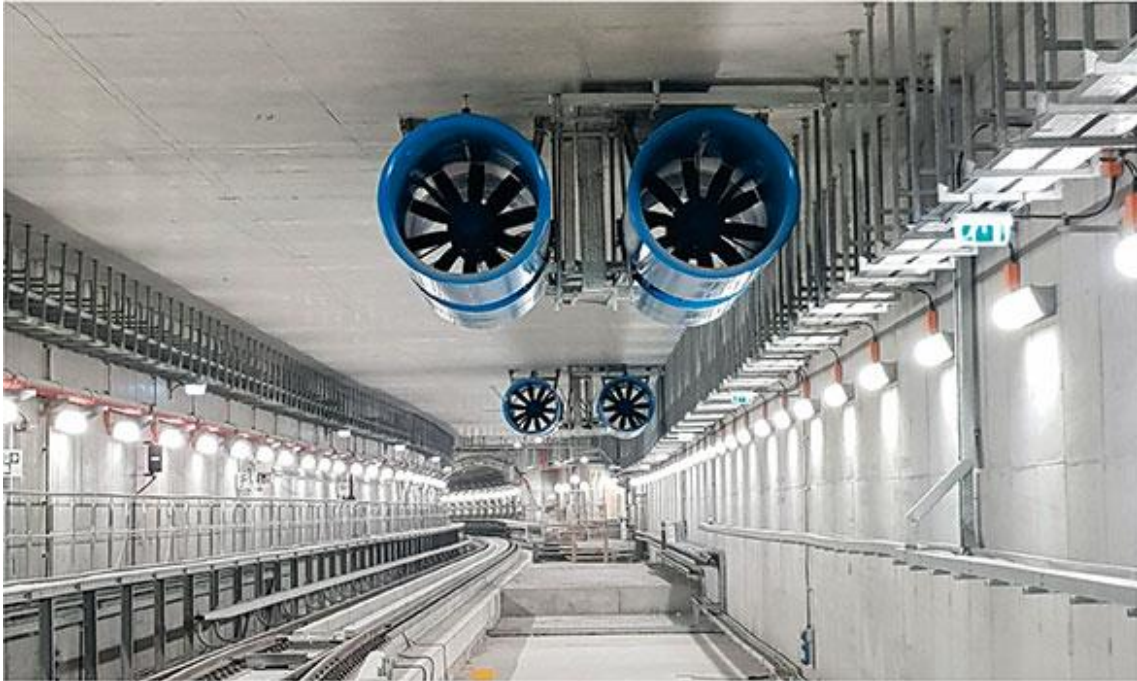
Σχήμα 2-7 Σύστημα μηχανικού αερισμού σε σήραγγα με χρήση ανεμιστήρων jet fans (TVF) (Zitron SA. 2023 1).
