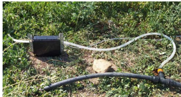
Εικόνα 66: Σύστημα άρδευσης του αγρού (Ηλεκτροβάνα) 1
