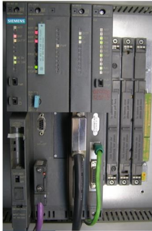
Εικόνα 5: PLC της Siemens τοποθετημένο σε rack.
