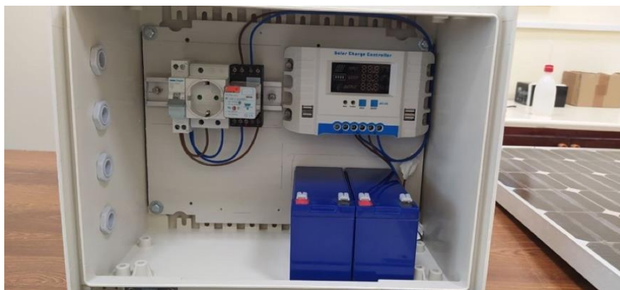
Εικόνα 47: Πίνακας Φ/Β συστήματος
