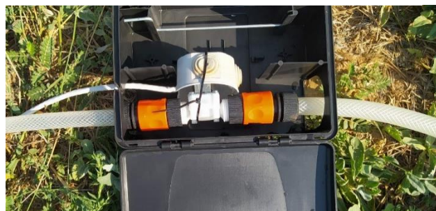
Εικόνα 67: Σύστημα άρδευσης του αγρού (Ηλεκτροβάνα) 2
