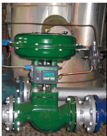
Εικόνα 16 Πνευματικός επενεργητής διαφράγματος με ρυθμιστή θέσης που τροφοδοτεί απευθείας στον ελεγκτή την πραγματική θέση της βαλβίδας [65]
