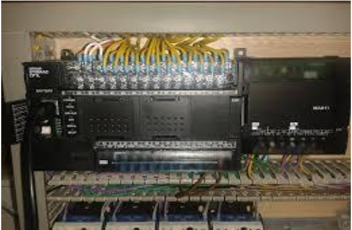
ΕΙΚΟΝΑ 6.5 ΕΛΕΓΧΟΣ ΣΤΑΘΜΗΣ ΝΕΡΟΥ ΜΕ ΧΡΗΣΗ PLC{28}
