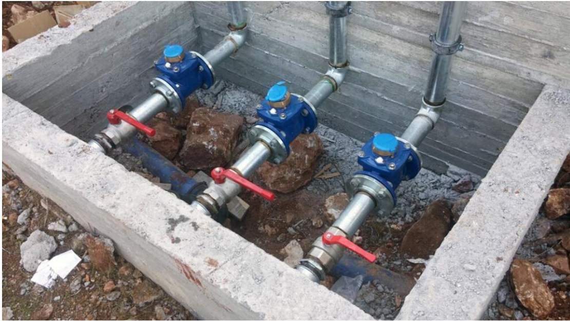
ΕΙΚΟΝΑ 6.3 ΣΩΛΗΝΕΣ ΥΔΡΕΥΣΗΣ ΜΕ ΑΙΣΘΗΤΗΡΙΑ ΕΛΕΓΧΟΥ{24}
