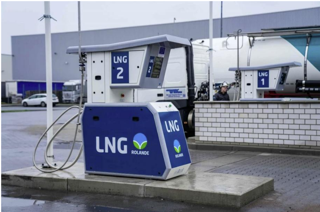
Εικόνα 26: Αντλία σε πρατήριο καυσίμων LNG στην Ευρώπη
