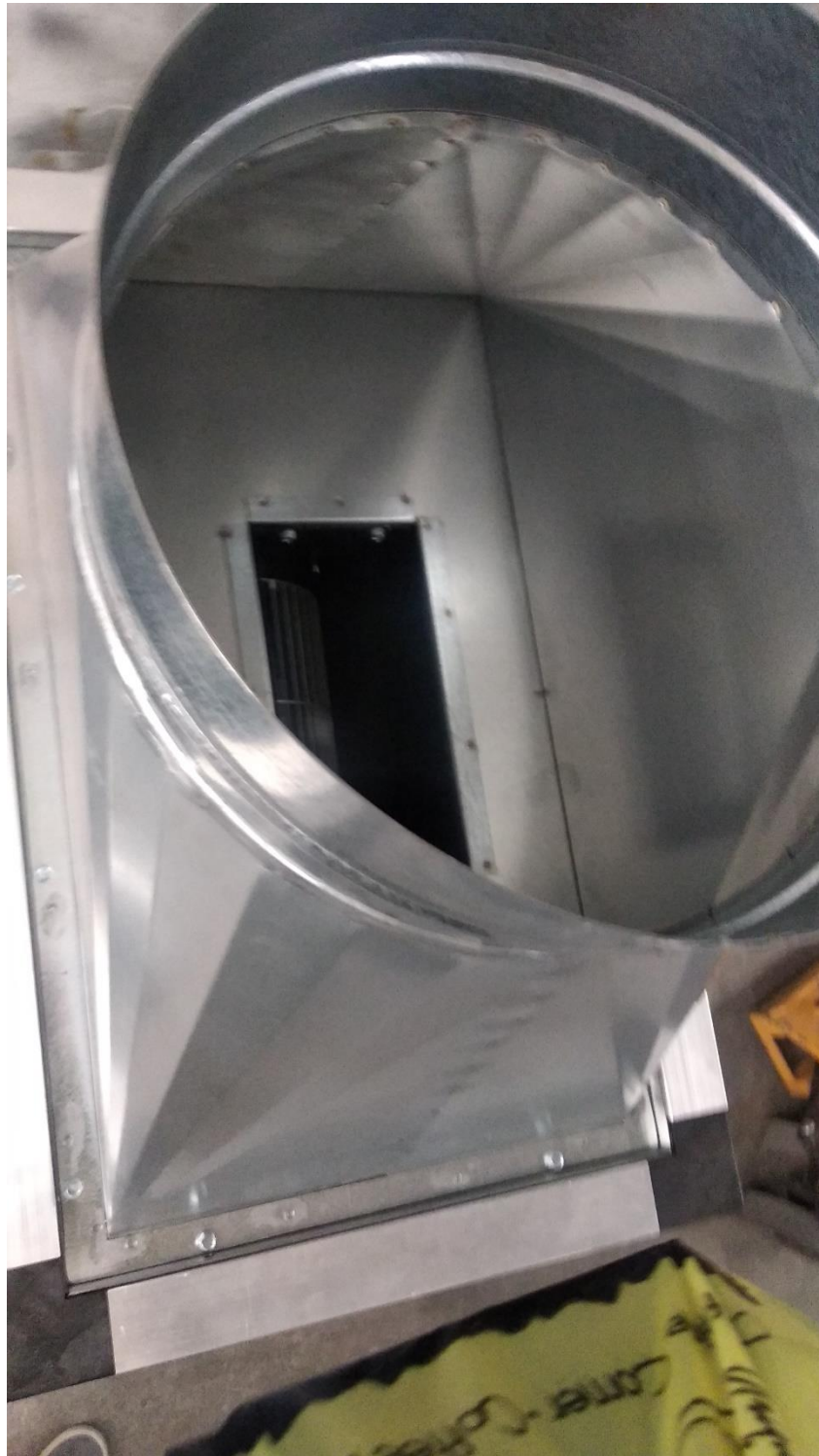
Ο Φυγοκεντρικός Ανεμιστήρας με οπτική από την έξοδο όπου βρίσκεται τοποθετημένος.
