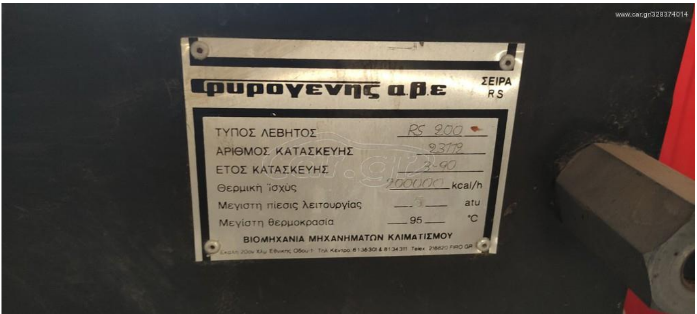
Εικόνα 30: Τεχνικά χαρακτηριστικά λέβητα
