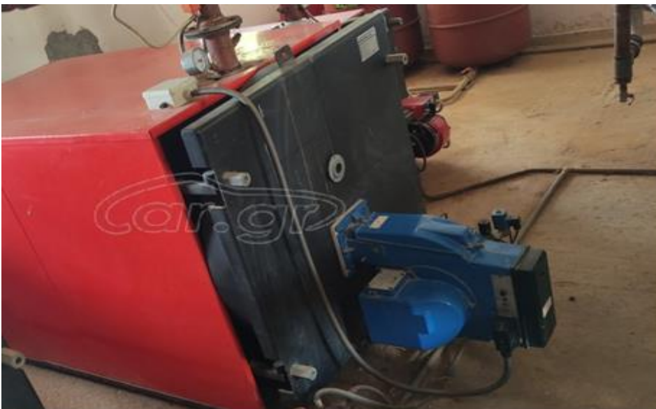
Εικόνα 29: Απεικόνιση λέβητα κτηρίου
