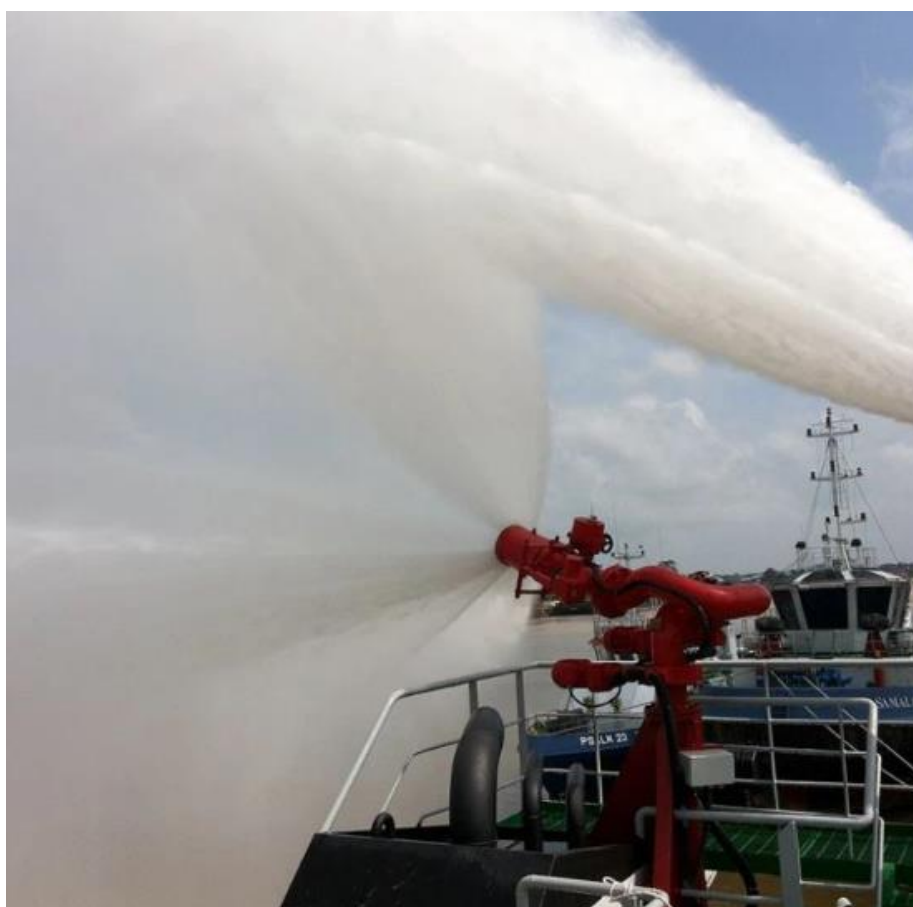
ΕΙΚΟΝΑ 11: Σύστημα πυρόσβεσης σε λειτουργία
