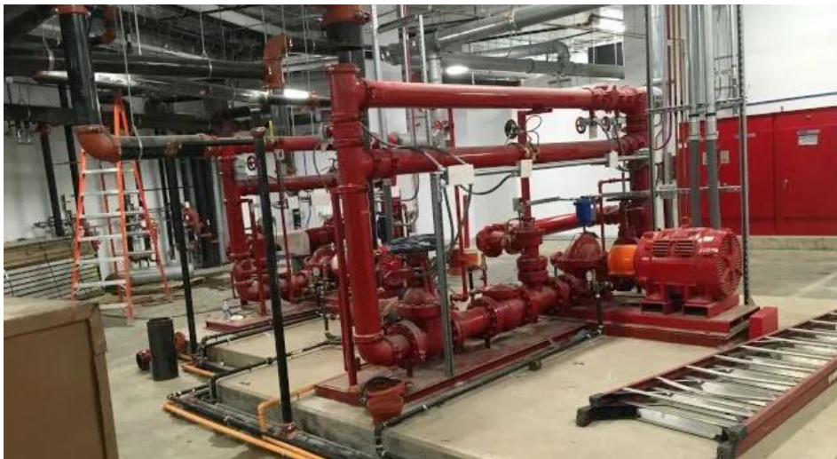
Εικόνα 2.3 Σύστημα επιτήρησης του νερού για πυροπροστασία
