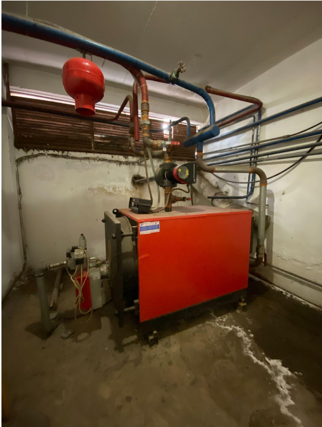
Εικόνα 19 Λέβητας φυσικού αερίου
