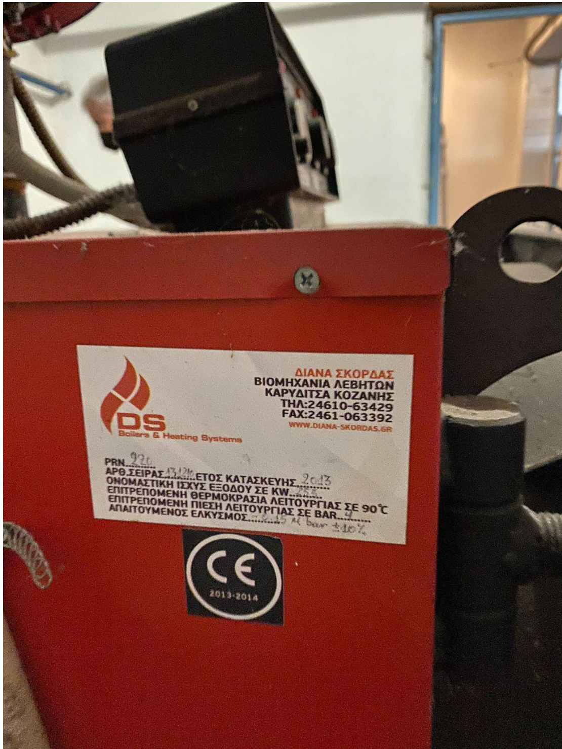
Εικόνα 20 Στοιχεία λέβητα φυσικού αερίου
